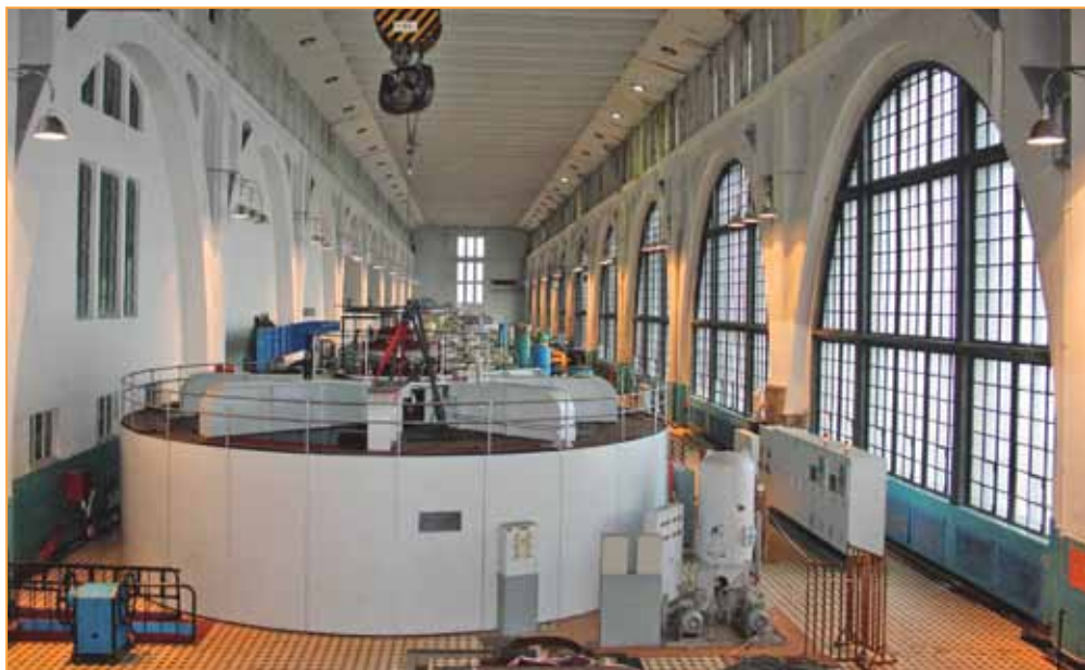
Машинный зал гидроэлектростанции
