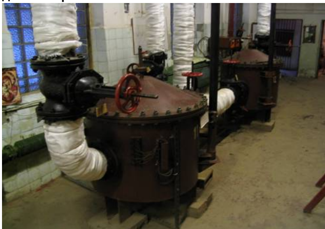
Рисунок 5. Аппараты АЭ-А-200, работающие в котельной № 12 «Тепловые сети г. Балашихи», Московская область
