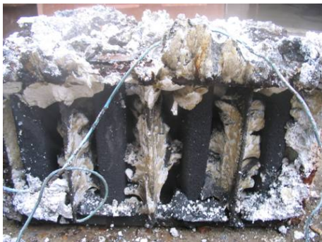
Рисунок 6. Кассета аппарата АЭ-А-120 с уловленными солями накипи из системы ГВС, котельная «Тепловые сети» г. Красноуфмск, Свердловская область
